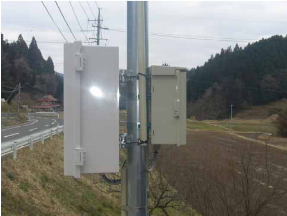
【猿人善快】本体は、日東の純正金具を使用して取付 背面のプラボックスは、リミッタ/ブレーカー収納ボックス アース棒からのIV線は、草刈り作業で痛められないよう養生
