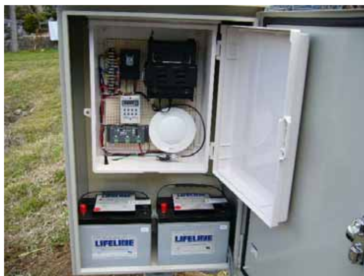
キャビネットには、10年間メンテナンス・フリーのバッテリー(80Ah)2個を収納 キャビネットの総重量は90Kg程度になります
