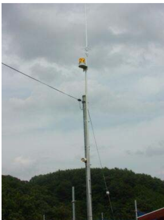
既設柱を利用 電源は商用(ハウスから)
