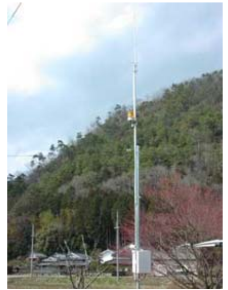
消防器庫脇に設置
