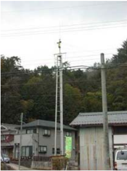
消防器庫脇に設置 アンテナ回転灯は火の見櫓
