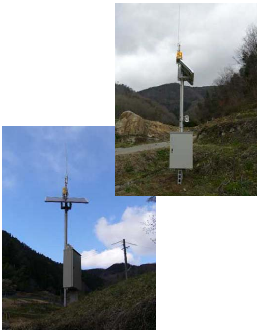
見通しの良い土手へ設置
